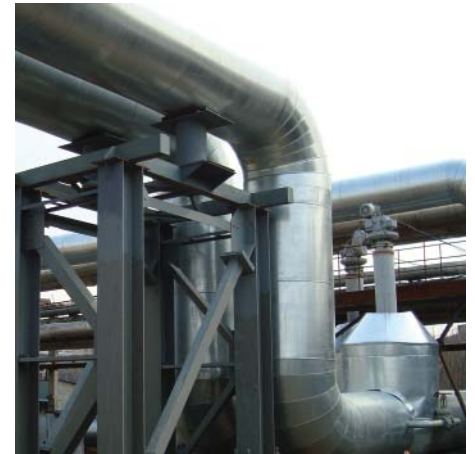
Системы вентиляции, кондиционирования и трубопроводы
